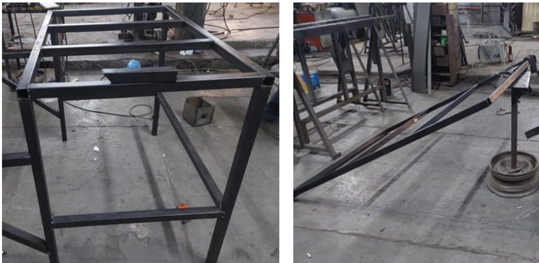
Figura 3. Base metálica que soporta al colector del secador solar. Elaboración propia
